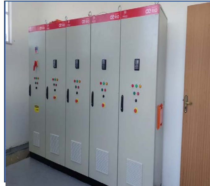
PAINEL DAS BOMBAS DA ELEVATÓRIA DE ÁGUA TRATADA
