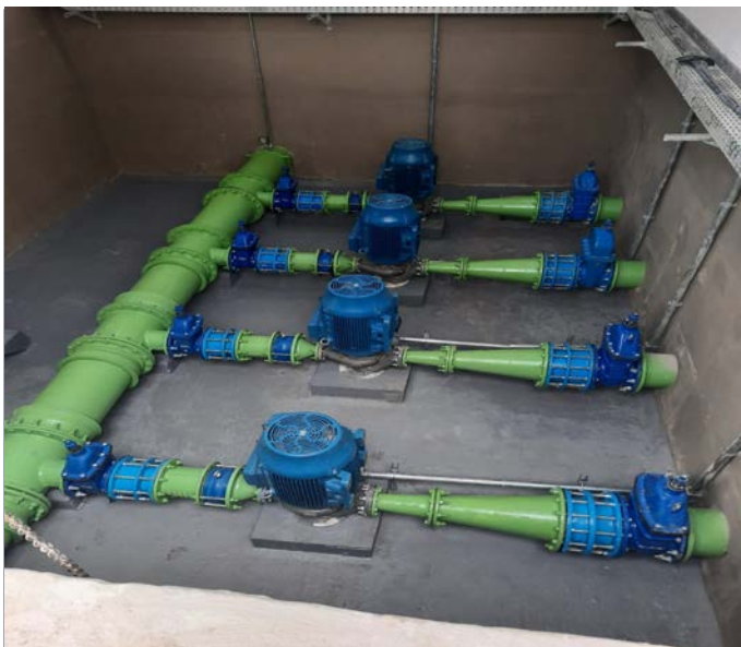
BOMBAS DA ELEVATÓRIA
