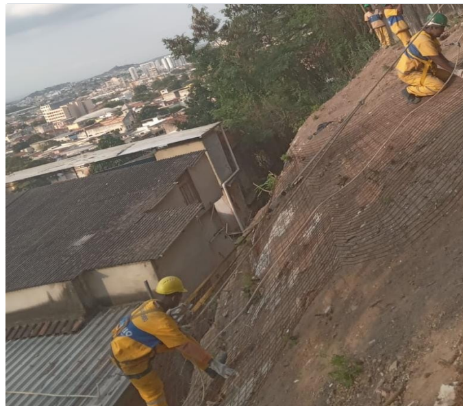
Colocação da tela do concreto projetado com viga estaqueada e canaleta de drenagem à serem executados
